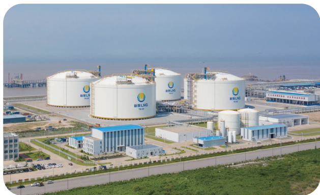
舟山LNG接收站二期项目投入运行
