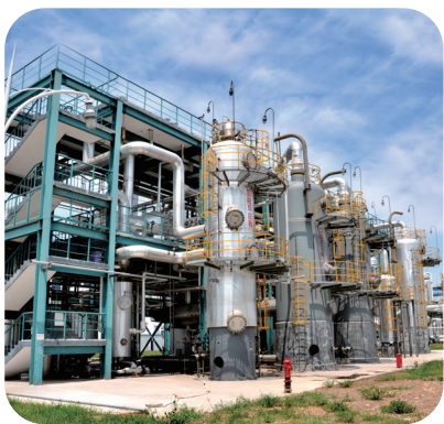
河南焦炉煤气制氢项目
